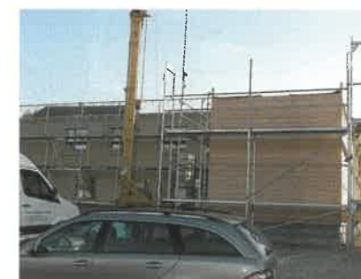
Nur gut eineinhalb Tage später: Die Gebäudehülle ist bereits wind- und regendicht, die Fenster wurden ebenfalls schon im Werk eingebaut. Auch das leicht nach hinten, nach Süden, geneigte Pultdach ist angebracht. Auch das Nebengebäude rechts steht.
