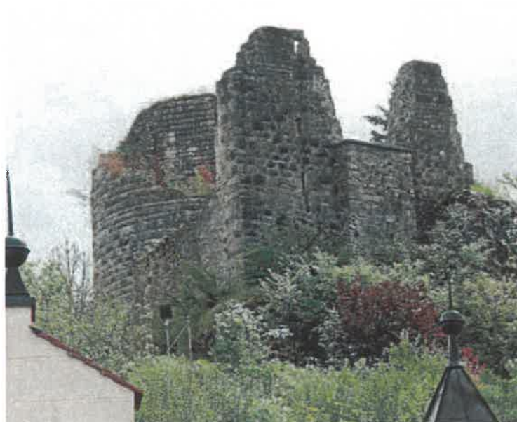
Die Sanierung der Burg ist ebenfalls ins Auge gefasst, für heuer die des Burgfriedes.
