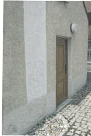
Ersetzt wurde auch bereits die Tür zur Sakristei. Am Sockel davon deutlich zu sehen, dass auch hier Ausbesserungen nötig sind.
