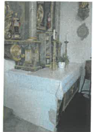
Auch im Innern sind einige Schäden am Mauerwerk zu beheben, vor allem an den beiden Seitenaltären. Fotos: az
