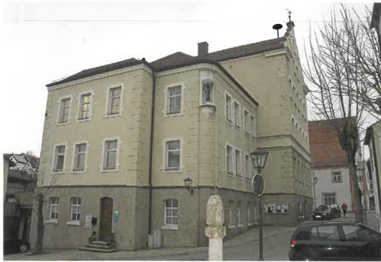
Das Rathaus ist das markante Gebäude im Marktzentrum. Eine umfassende Sanierung ist nötig. Fotos: az
