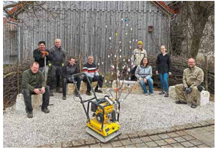
Mit Spaten, Pickel und Schaufel werkten rund ein Dutzend Mitglieder an der Neugestaltung des Dorfplatzes vor dem Gemeindestadel.
