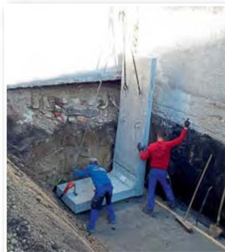
Meterhohe Beton-L-Steine halten dem Druck der Nachbargebäude stand – im Frühjahr kann die Fläche für die weitere Nutzung befestigt werden.
