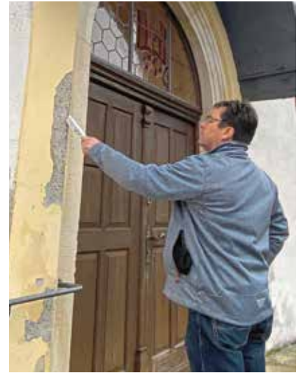
Kirchenpfleger Anton Treffer, der sich im Team der Kirchenverwaltung federführend um die Baumaßnahme kümmert, zeigt Probestellen für die Zusammensetzung des bisherigen Mauerputzes.
